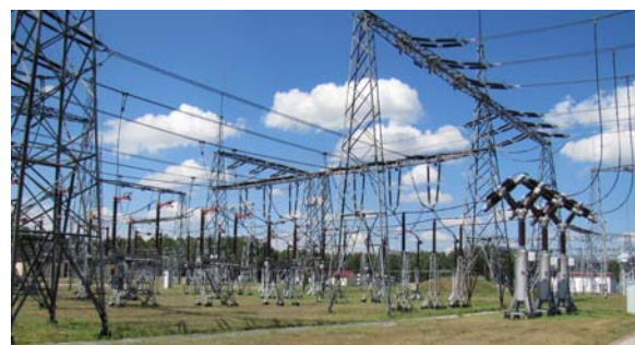
Fragment istniejącej rozdzielni 220 kV
