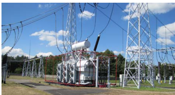
Istniejący transformator 400/110/15 kV
